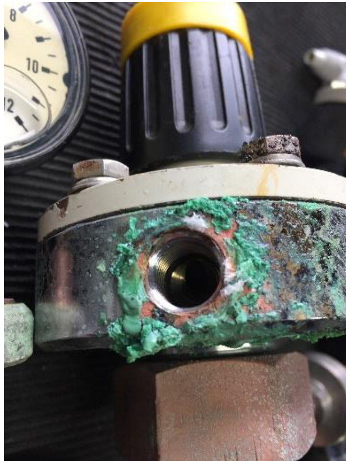
Bild 7 durch Chloraerosole angegriffenes Vakuumregelventil
