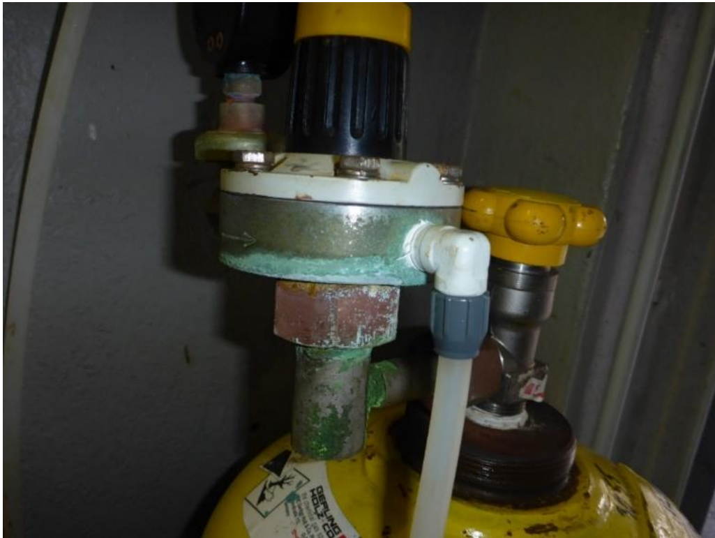
Bild 8 durch ausgetretenes Chlor und Luftfeuchtigkeit angegriffenes Vakuumregelventil
