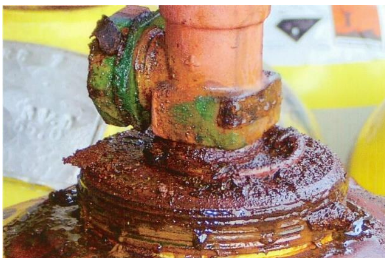
Bild 2 Korrosion durch nicht ordnungsgemäß festgeschraubte Verschlussmutter
